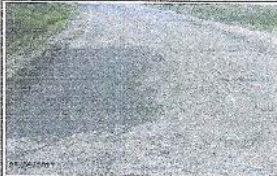
FOTO 01 RUTA: 6002 SECTOR: PR 24-120 OBSERVACIONES: VARIOS BACHES TRAMO D
