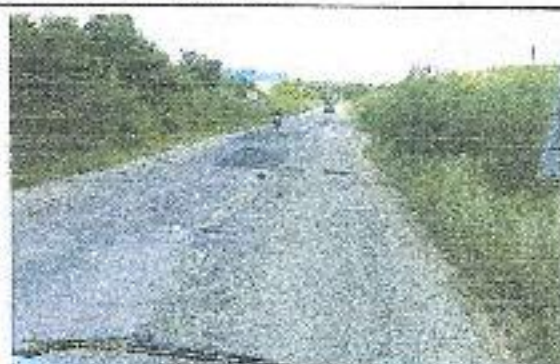
FOTO 06 RUTA: 6002 SECTOR: PR 24-120 OBSERVACIONES: VARIOS BACHES TRAMO D
